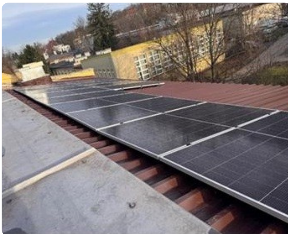
Instalacja fotowoltaiczna na dachu budynku ZS im. Władysława Szybińskiego w Cieszynie
